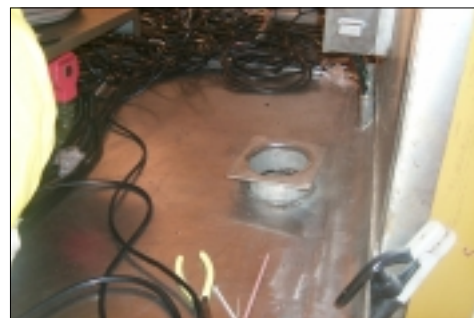
그림 4. 핫셀 작업구역에 설치한 배선용 연결장치.
