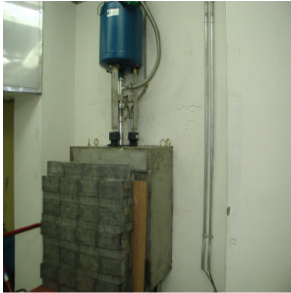
그림 3. 설치가 완료된 BNCT 조사장치 전면부(납벽돌로 임시 차폐).
