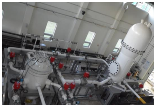
플랜트 배관 누출 테스트베드 A
