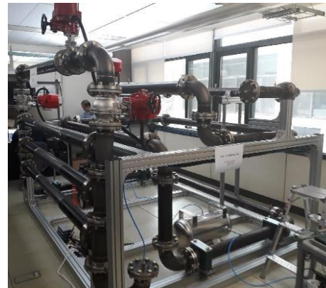
플랜트 배관 누출 테스트베드 B
